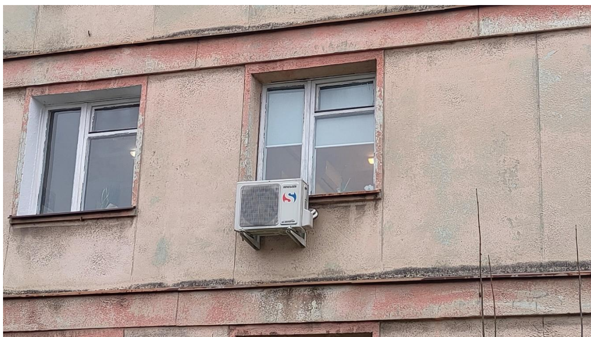
Photo 2. Appareil de climatisation individuel (de type split).
