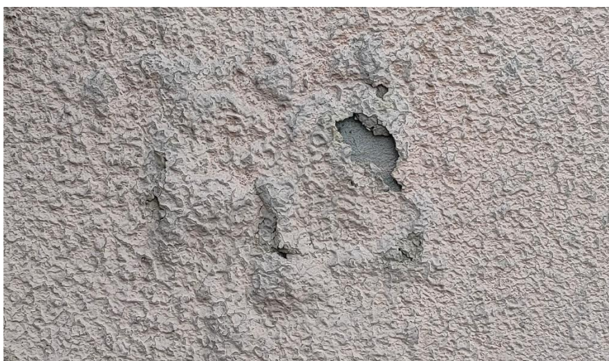
Photo 4. Murs extérieurs montrant l'état de détérioration du plâtre dû à la couche mince et à l'humidité
