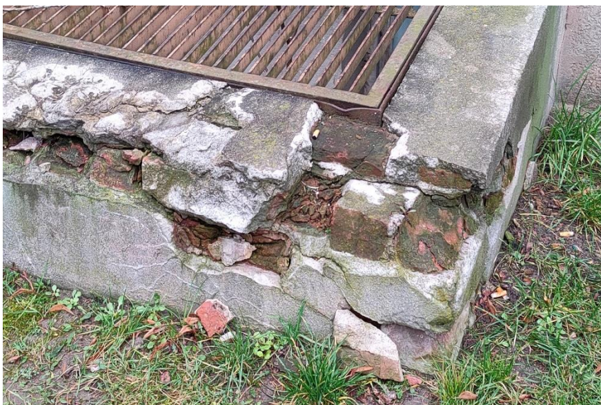
Photo 3. Dégradation de la structure des fenêtres du sous-sol due à l'infiltration d'eau et à la force mécanique
