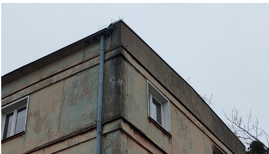
Photo 12. Humidité due aux intempéries et dommages aux solins de toiture.
