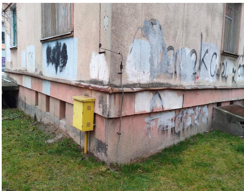
Photo 8. Manque d'isolation extérieure et dommages aux solins en tôle, entraînant des problèmes d'humidité à l'intérieur et à l'extérieur du bâtiment.
