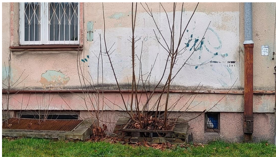
Photo 13. Arbres et buissons auto-ensemencés détruisant les structures en briques des soupiraux et permettant la pénétration de l'eau dans les murs.
