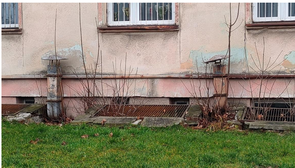
Photo 15. Le système de ventilation est obsolète et nécessite un audit et un remplacement.
