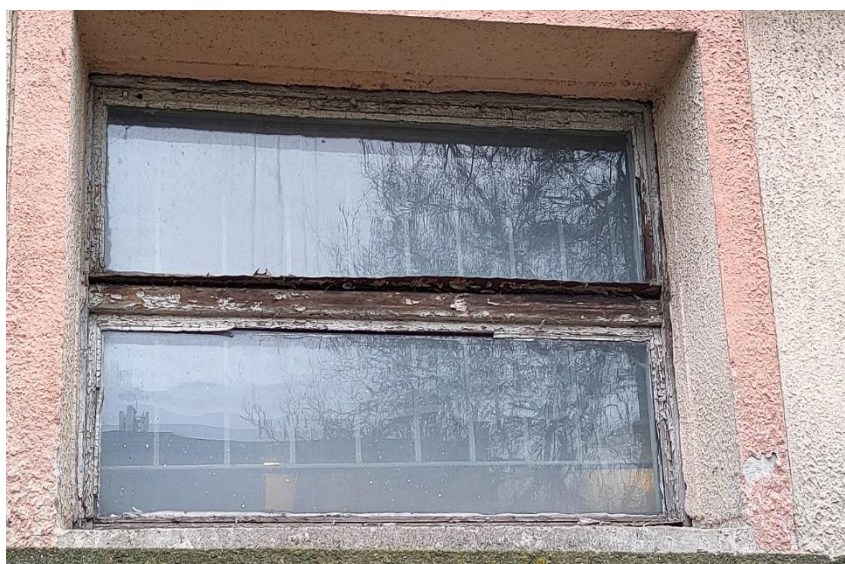
Photo 9. Une vieille fenêtre en très mauvais état, avec de la peinture écaillée et des dommages aux solins métalliques, le tout dû à l'absence d'entretien régulier et approprié
