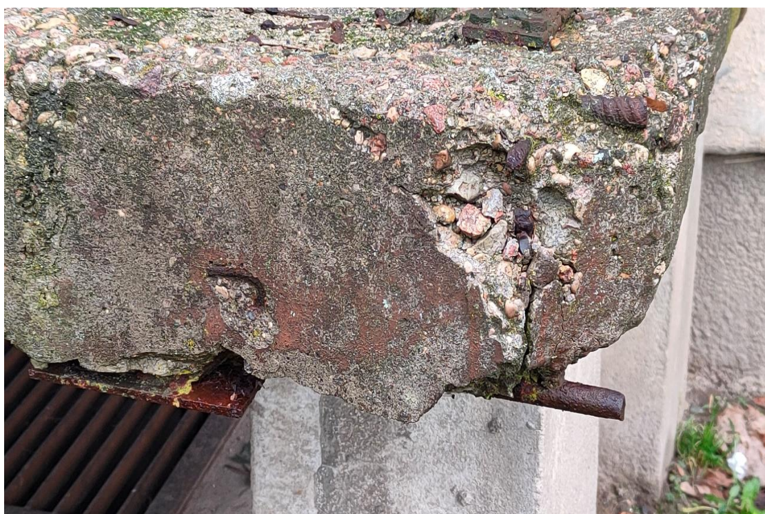
Photo 5. Plate-forme d'entrée présentant des décollements ainsi que des fers à béton exposés et rouillés
